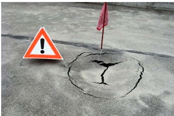
Das ausströmende Wasser hat den Belag arg beschädigt
